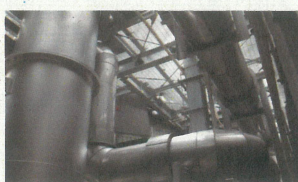
プラント配管
